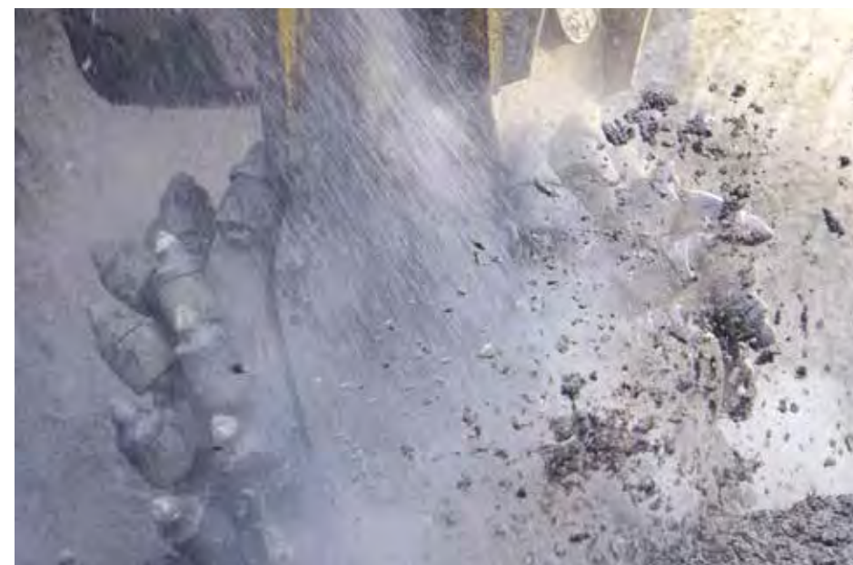
Eine VC 2000 Fräse im Einsatz. Die V-förmige Anordnung der Schneidtrommeln ermöglicht einen Schnitt mit flacher Sohle. Auf dem Stand von Ascendum wird auch ein ECR50F twindrive mit dem innovativen Epiroc SB 202 zu sehen sein.
