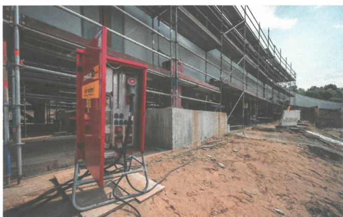
Von der Montage bis zum Rückbau: Fachkräfte von Zeppelin Rental analysieren den individuellen Strombedarf und richten eine bedarfsgerechte Elektro-Baustelleneinrichtung ein
